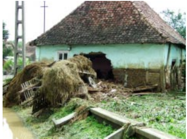
Beomlott oldalú ház Kobátfalván House with ruined side in Kobátfalva
