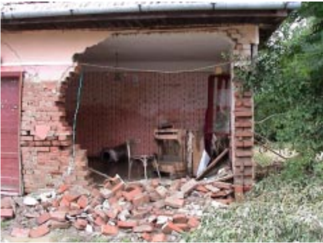
Beomlott oldalú ház Kiskadácsban House with ruined sides in Kiskadács
