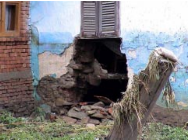
Megrongált oldalú ház Kobátfalván House with ruined side in Kobátfalva
