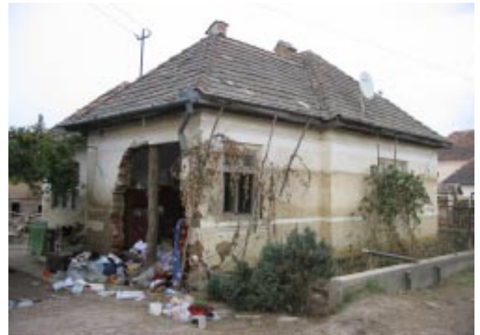
Beomlott oldalú ház Kobátfalván House with ruined side in Kobátfalva
