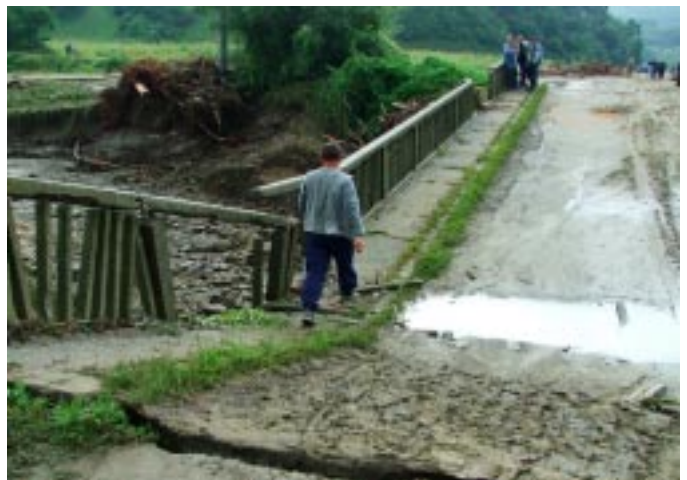
A megrongálódott Küküllő-híd The damaged bridge over the Küküllő river
